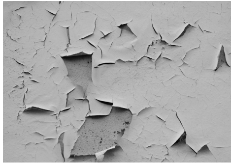
Las pinturas de esmalte y con base de látex habitualmente se descaman en tiras y se despegan.
